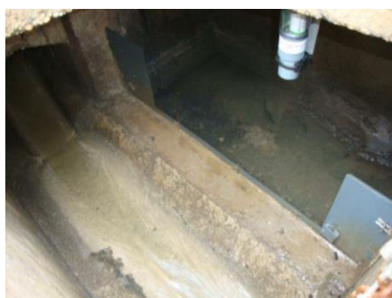
Figure 4 : Exemple de lame déversante
